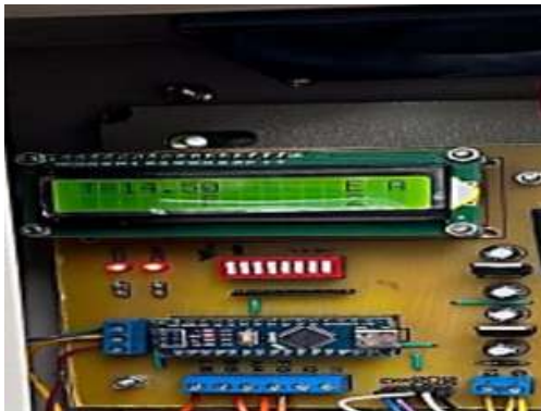
Gambar 3.2 Tampilan Awal LCD pada Incinerator
