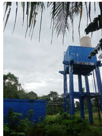
Gambar 6 Sarana Pamsimas yang Tidak Terawat
