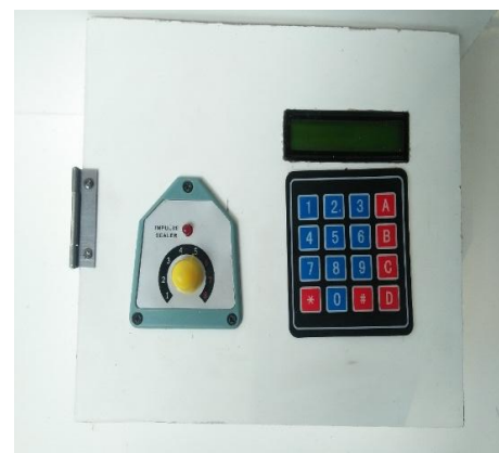
Gambar 9. Kontrol panel konveyor
