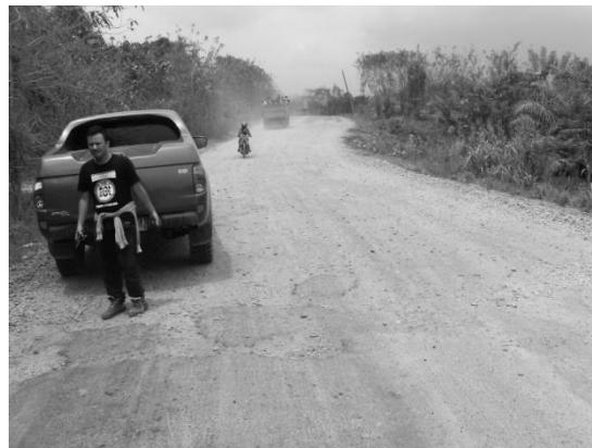
Gambar 13. Potensi slump di badan jalan pada batulempung yang bersisipan dengan batupasir, difoto ke arah utara
