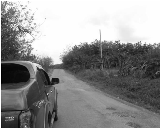
Gambar 14. Kenampakan tiang listrik yang miring akibat adanya creep , difoto ke arah selatan
