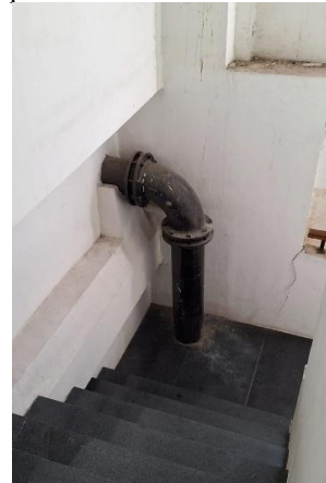
Gambar 6 Pipa Air Sumber : Dokumentasi Pribadi
