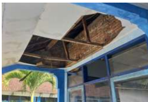
Gambar 2. Potret Kerusakan pada Atap dan Jendela
