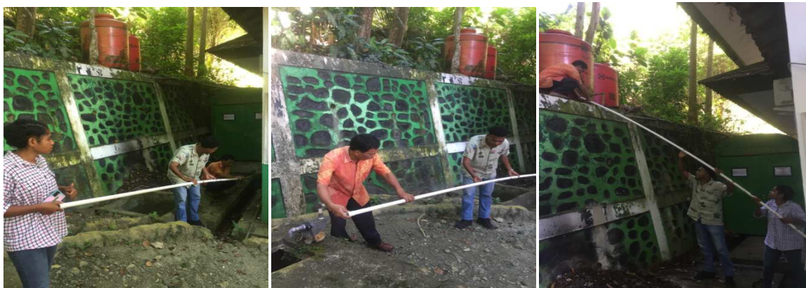
Gambar 5. Instalasi Pemipaan (Sumber: Dokumentasi Lapangan, 2023)
