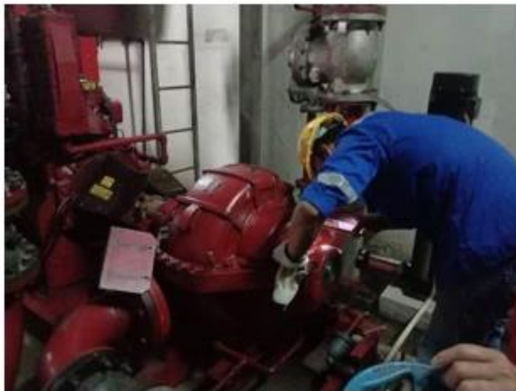
Gambar 5. Pengecekan Sistem Hydrant
