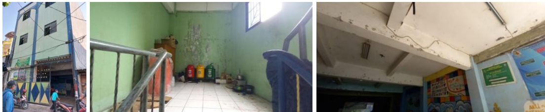
Gambar 1. Kondisi Bangunan Sekolah di RW 02, Kelurahan Krendang
