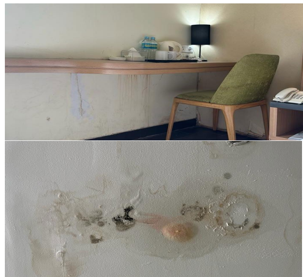
Gambar 2. Kerusakan Komponen Arsitektur
