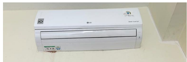
Gambar 3. Kerusakan Komponen Mekanikal
