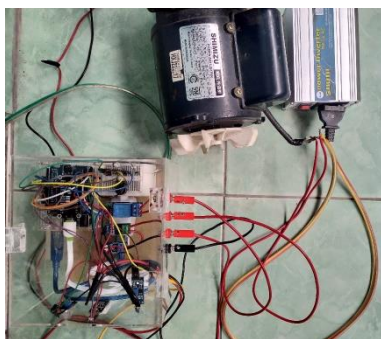
Gambar 20. Pengujian sistem kontrol dengan sumber inverter 220VAC
