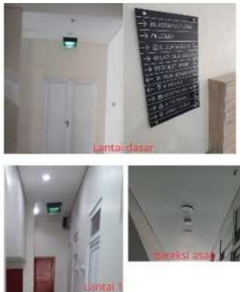
Gambar 10. Penanda dan alat deteksi asap Sumber: dokumentasi pribadi, 2024
