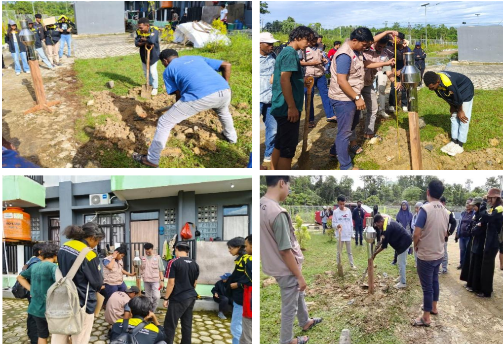
Gambar 3. Praktik Pemasangan Ombrometer
