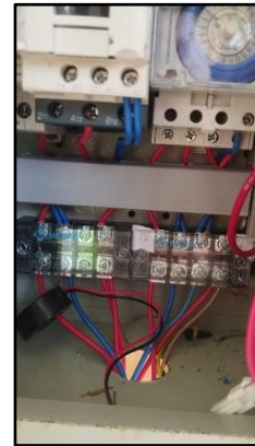
Gambar 18. Pemasangan NO Kontaktor Ke Beban Pompa Air
