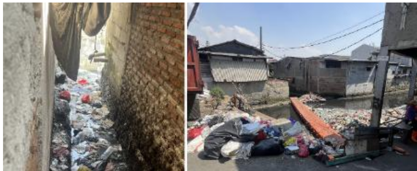
Gambar 7. Kondisi saluran drainase eksisting Sumber : Dokumentasi Tim Pelaksana
