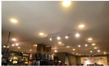
Gambar 11. Penggunaan downlight Sumber: Dokumentasi Pribadi
