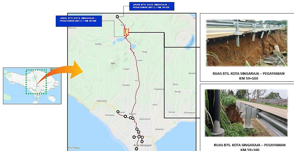
Gambar 1. Detail lokasi dan dokumentasi longsor di titik jalan Singaraja-Mengwitani, Bali
