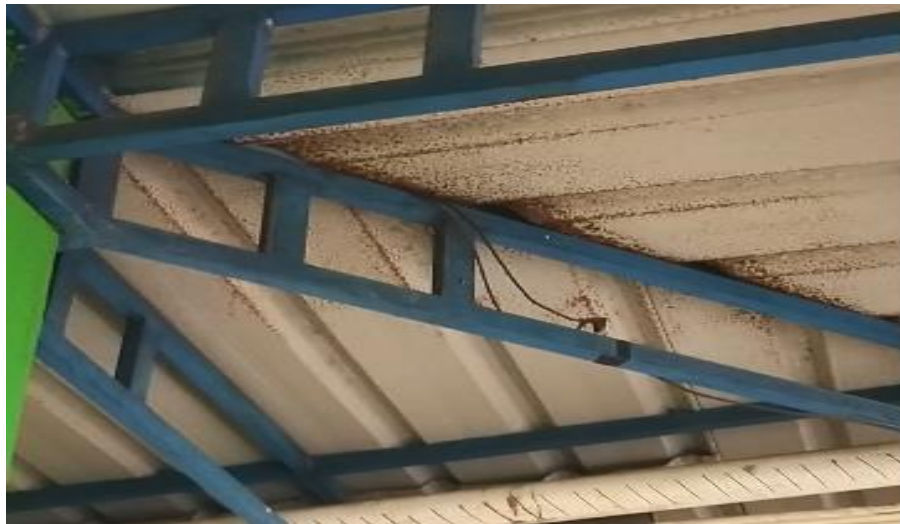
Gambar 2. Kabel Instalasi bersambungan tidak dalam pipa isolator
