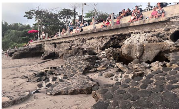
Gambar 2. Kerusakan Bangunan Pengaman Pantai Sea Wall di Pantai Batu Mejan (Hasil Analisis, 2024)
