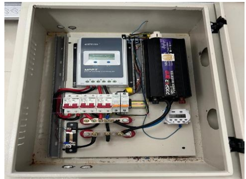
Gambar 20. Penempatan Box Control Panel
