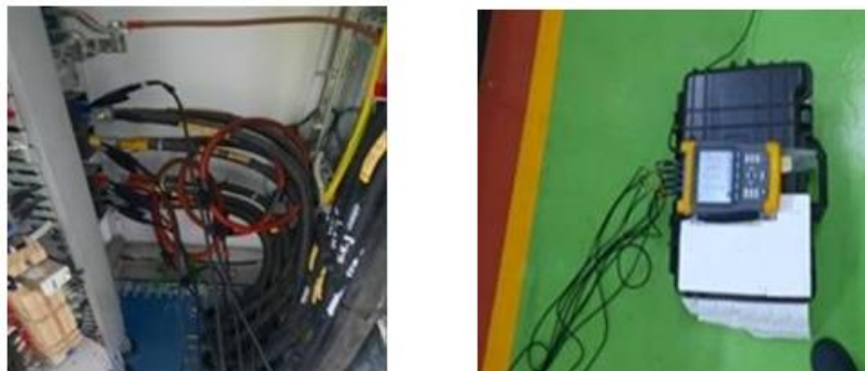
Gambar 2. Pemasangan Power Quality Meter
