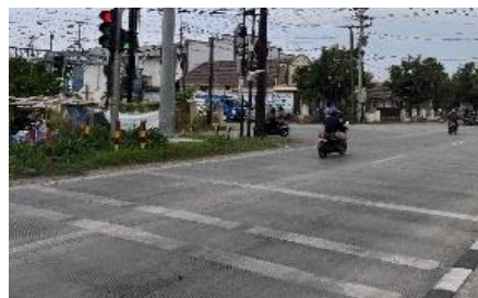
Gambar 9 Defisiensi Marka Jalan
