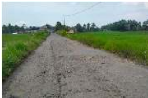
Gambar 2. Kerusakan jalan Kecamatan Sukaratu
