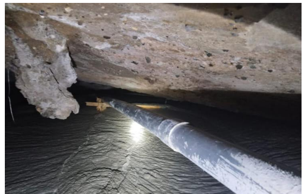
Gambar 1. Celah mendatar pada bawah oprit jembatan
