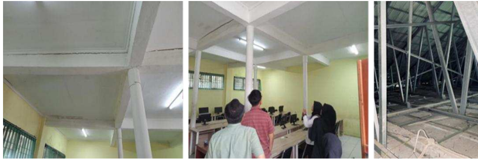
Gambar 4. Retak pada kolom dan balok bangunan praktik komputer
