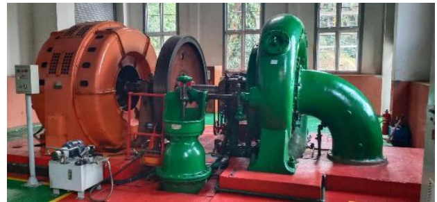
Gambar 4. Turbin PLTA Plengan Unit 5
