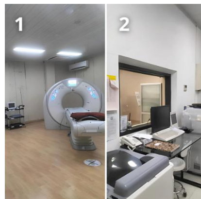
Gambar 2. Ruang CT Scan RS Bhayangkara Makassar (1) dan Ruang Kontrol CT Scan RS Bhayangkara Makassar (2)
