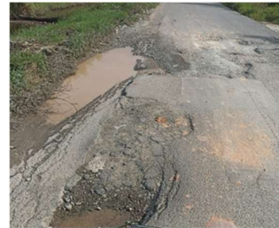
Gambar 1 Contoh Kerusakan yang Terjadi di Jalan Sultan Syarif Kasim
