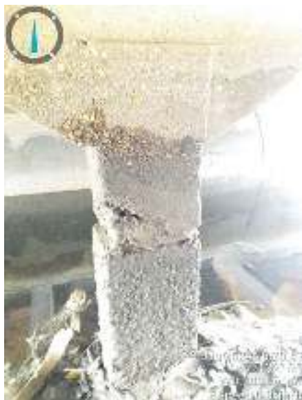
Gambar 4 Kondisi pada pilar jembatan Sumber : (Dokumentasi Skripsi 2024)
