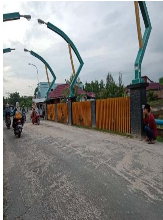
Gambar 1 Kondisi pada struktur lapisan atas jembatan
