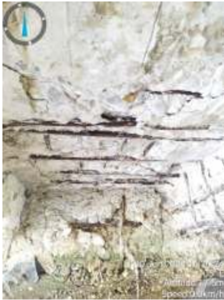
Gambar 2 Tampak struktur jembatan terkelupas dan korosi Sumber : (Dokumentasi Skripsi 2024)
