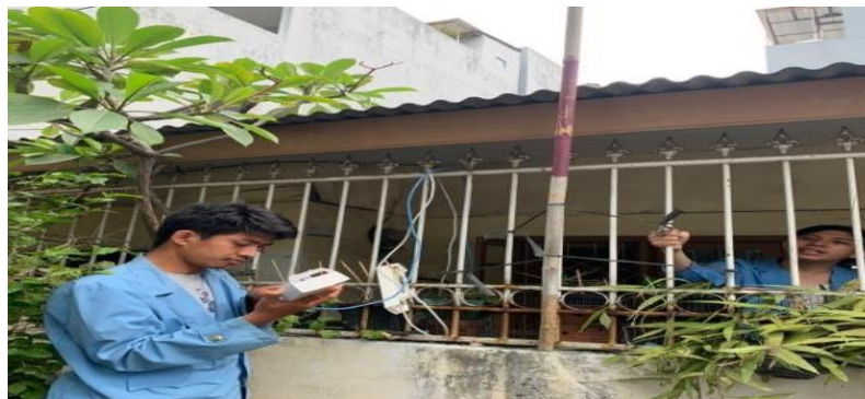
Sumber: Mohammad dzulfikar, 2022 Gambar IV.9 Instalasi TP Link CPE220
