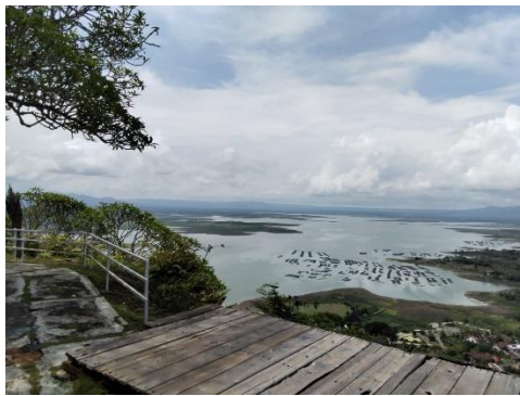
Gambar 3. Spot Kayu yang Sudah Rapuh.
