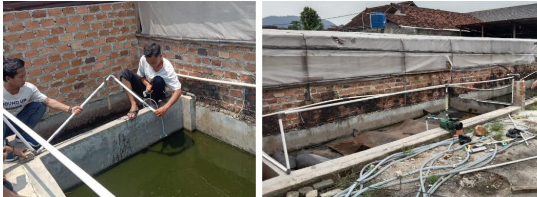
Gambar 7. Instalasi Microbubble generator pada limbah cair kotoran sapi di CV Sanjaya Farm
