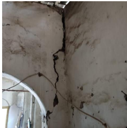
Gambar 2. Keretakan dinding rumah tinggal di daerah Bendung Sumber: Herlina, L et al (2023)
