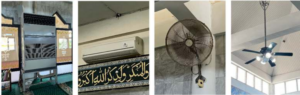
Gambar 11. Fasilitas Penyejuk Masjid Agung Al-Furqan
