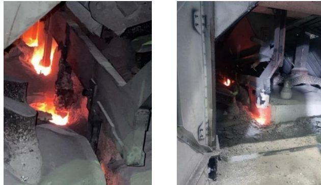
Gambar 9 Elephant Leg pada Crust Breaker dan Crust Breaker menyentuh Anoda
