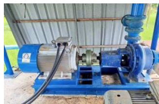
Gambar 1. Pompa Sentrifugal Sumber: Dokumentasi Peneliti
